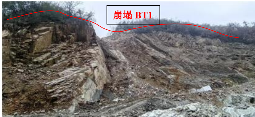
照片 3-1 BT1 崩塌全貌图（镜像 305°）
